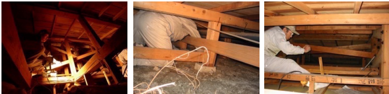
耐震調査・診断以外にも詳細な建物調査を実施し、総合的な建物調査としています（佐藤工務店）
