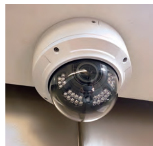
▲天井に設置された防犯カメラ
