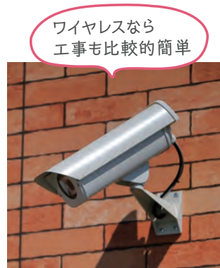
▲外壁に設置された防犯カメラ
