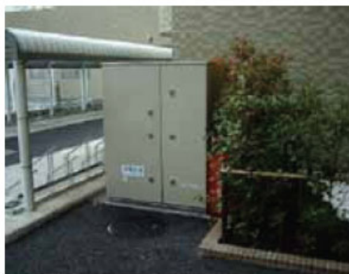
a. 自家用受変電設備例
