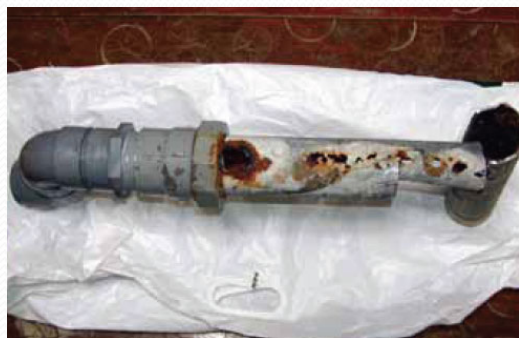
亜鉛めっき鋼管の劣化
