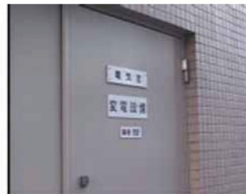
c. 借室変電室例
