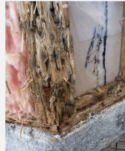
腐朽菌などによる 木材の腐れ
