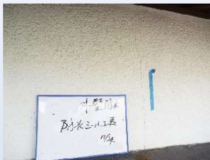
外壁のひび割れ
