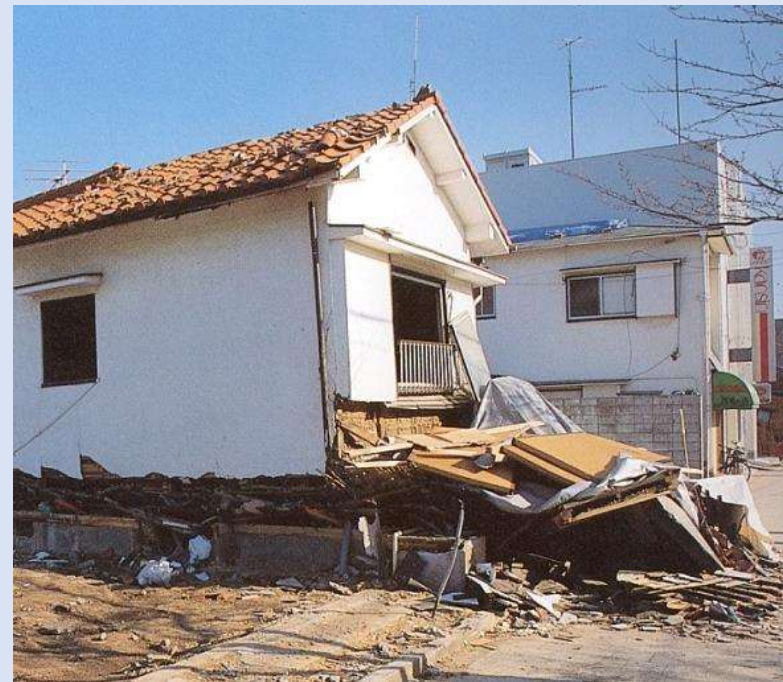
1階のみがつぶれた
