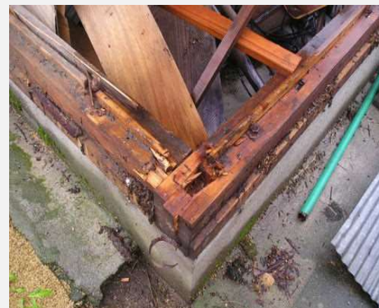
ホゾ抜けが発生した後
